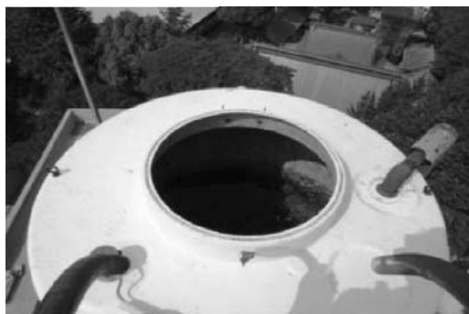
蓋が外れている貯水槽
