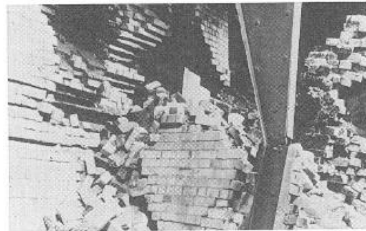
芝製造所発生炉の崩壊状況
