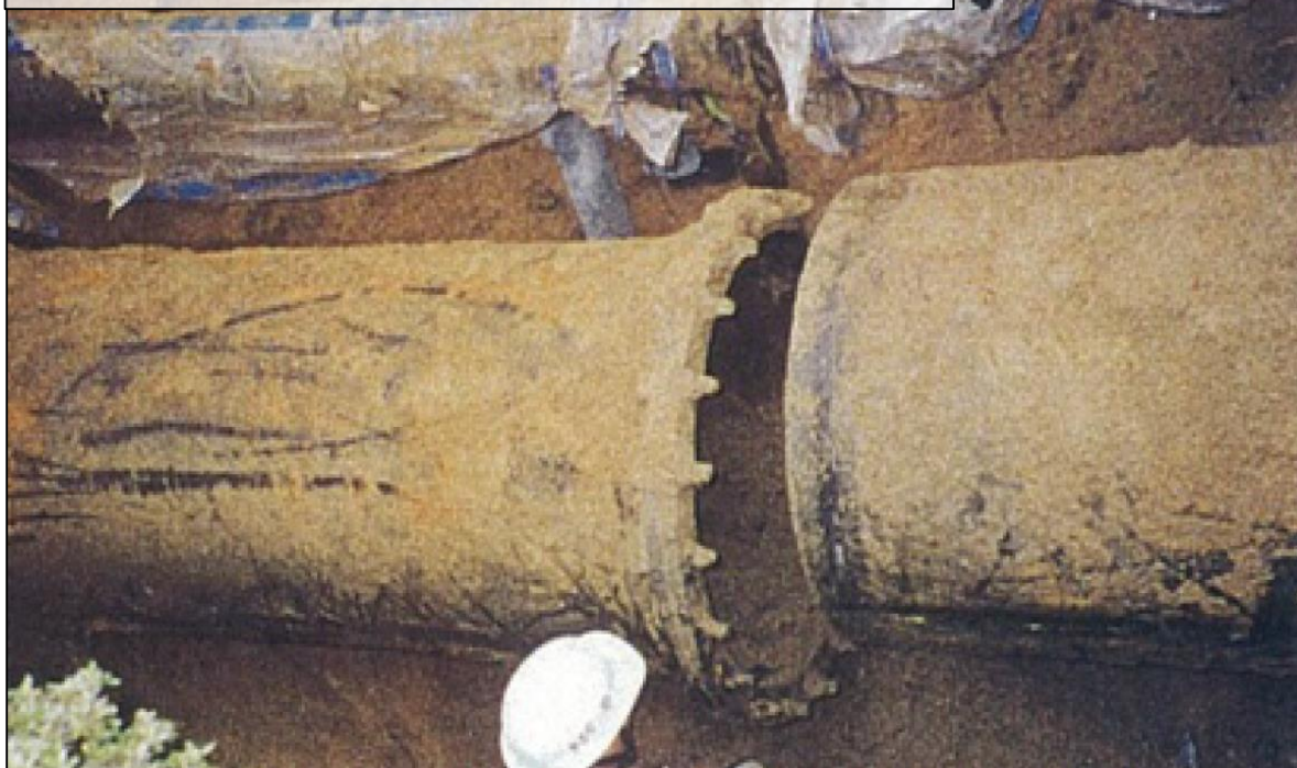
管路の抜け出し (阪神・淡路大震災)
