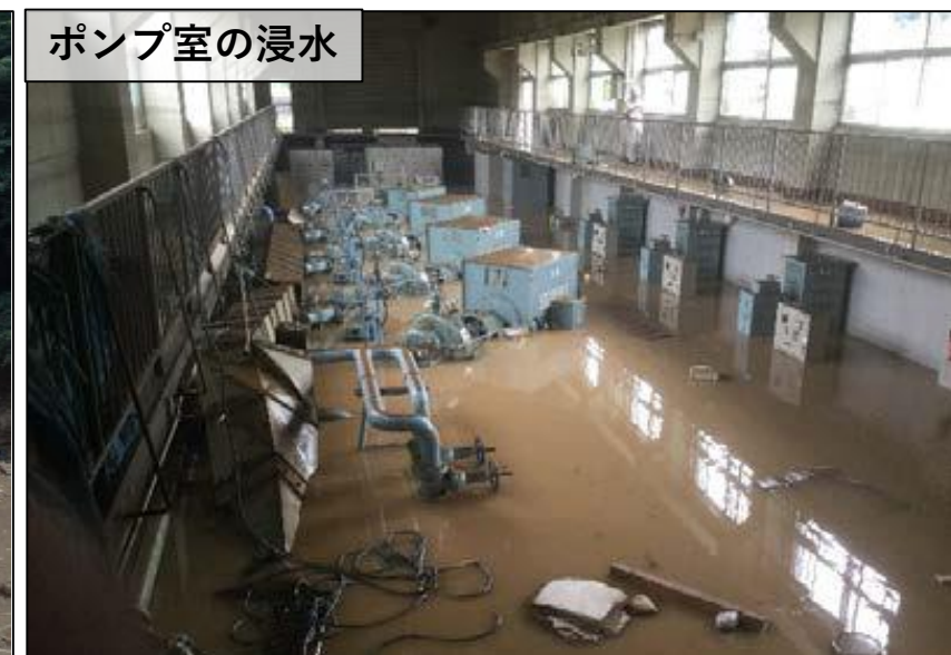
【平成30年7月豪雨災害（広島県）】
