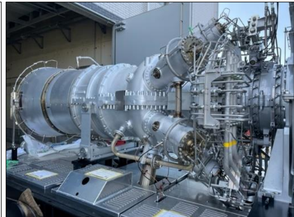
【自家用発電設備の設置】
