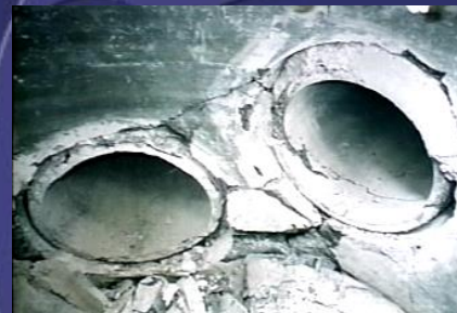
下水道管の突出し(①阪神・淡路大震災)
