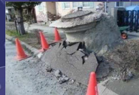
液状化によるマンホールの浮上 (②東日本大震災)
