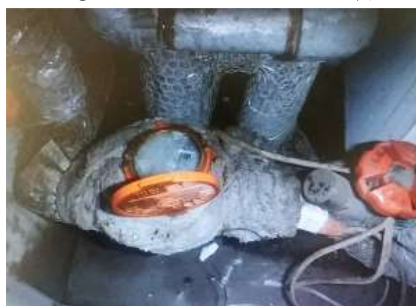
④マンションPS内のメーター破裂
