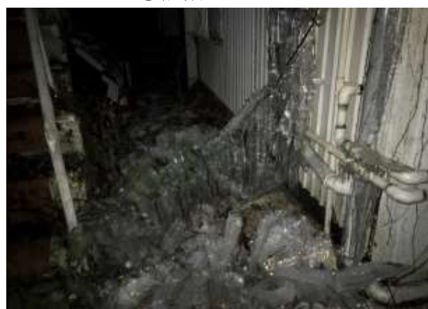
③給湯器からの漏水
