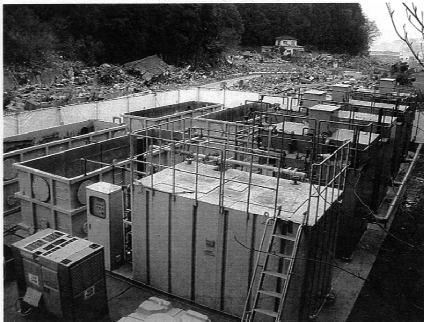
陸前高田市では、下水処理場の代替として日立プラント建設サービスの提案により緊急対策としてMBRプラントを導入、同市鳴石地区で応急汚水処理を実施
