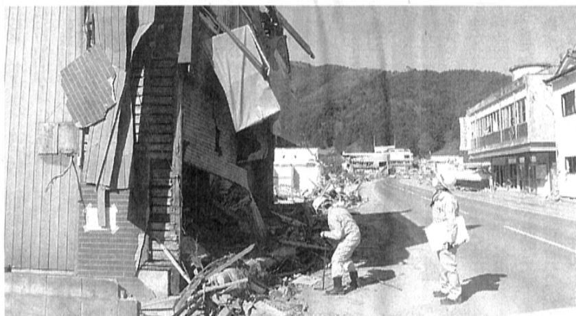
瓦礫の中での漏水調査や復旧作業が進められている (さいたま市による石巻地方(企)での応援活動)
