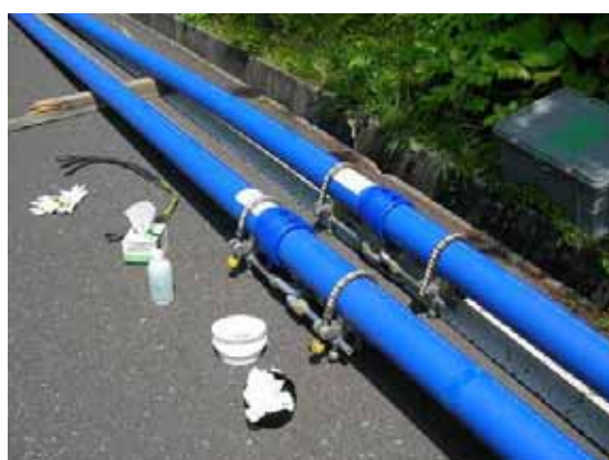
仮設配管（ポリエチレン管）
