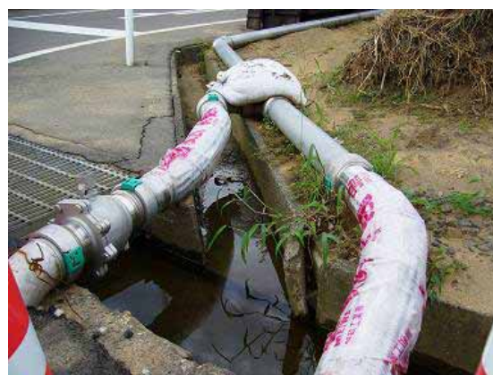
仮設配管（ステンレス管）
