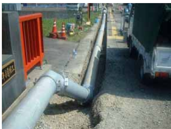
仮設配管（ステンレス管）
