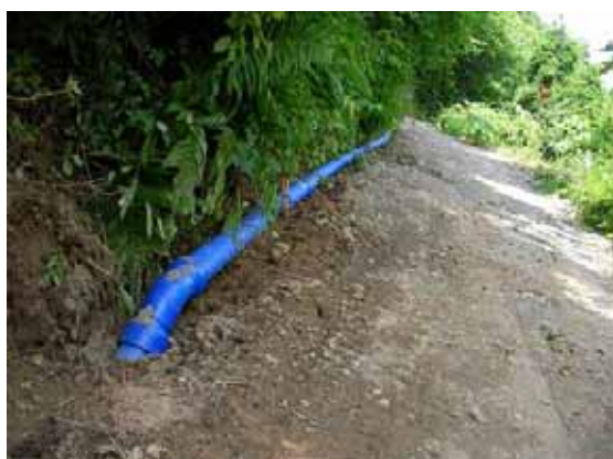
仮設配管（ポリエチレン管）
