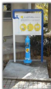
説明用看板と地上式給水栓
