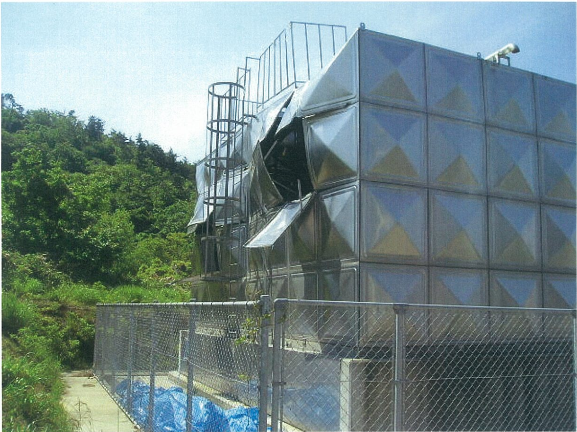
写真 5.2 剣地配水池の被害状況 (2)
