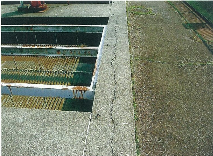
写真 5.10 上野浄水場沈殿池 クラック
