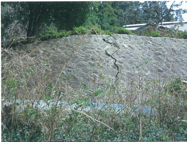
①擁壁の亀裂 (幅 5~10cm)
