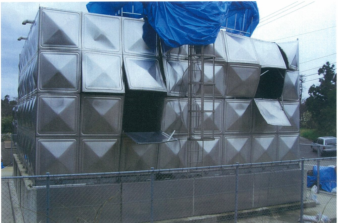
写真 5.1 剣地配水池の被害状況 (1)
