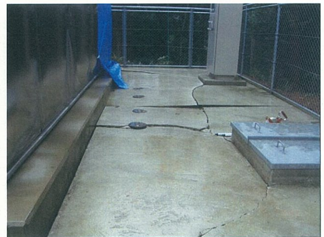
④土間コンクリートの亀裂・沈下
