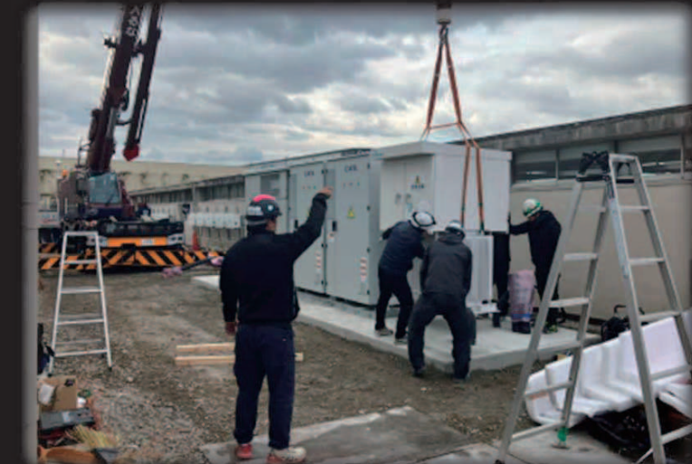
蓄電池設備一式新設
