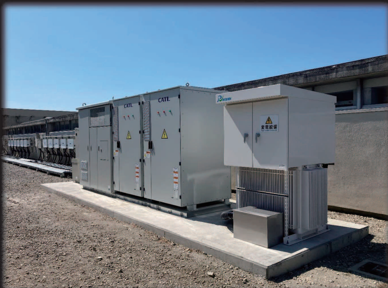
蓄電池設備一式
