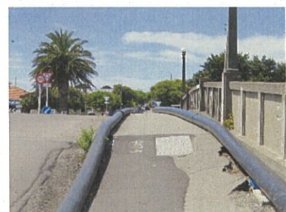
下水道真空圧送
