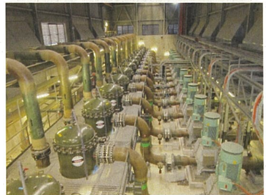
1次膜ろ過施設(左)と加圧ポンプ(右)
