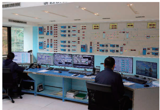
図-22 中央監視装置
