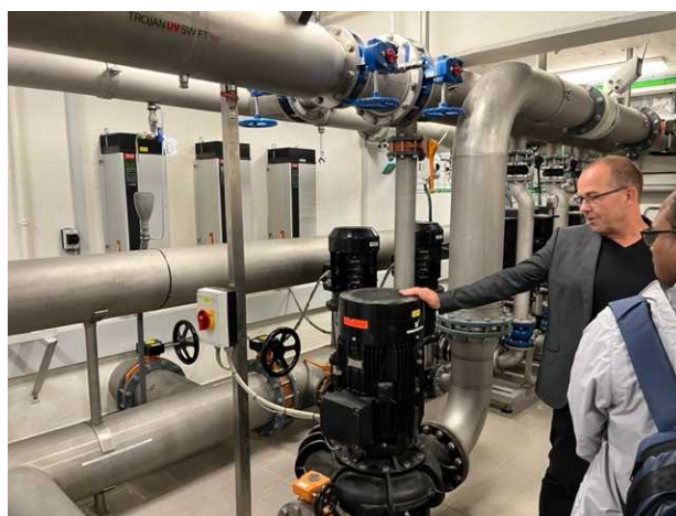
写真-11: ビアケレズ水道の紫外線処理設備
