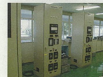
保護継電器試験装置
