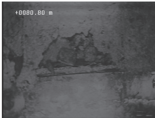
写真2 ケーシングパイプの破損
