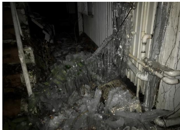
③給湯器からの漏水
