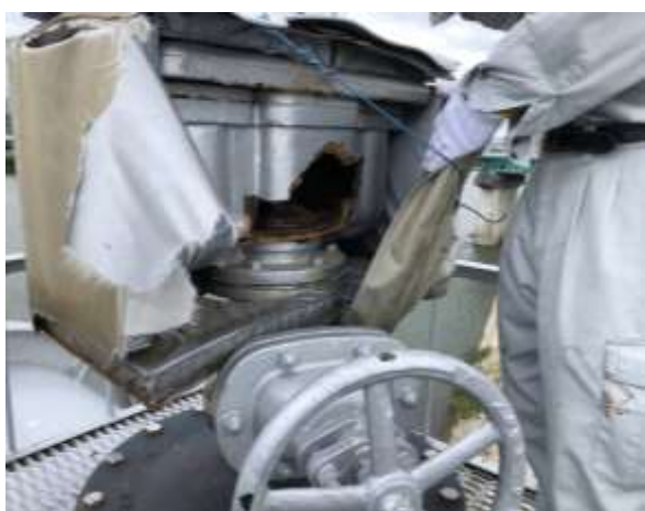
②-3：φ1200SP（空気弁から漏水）
