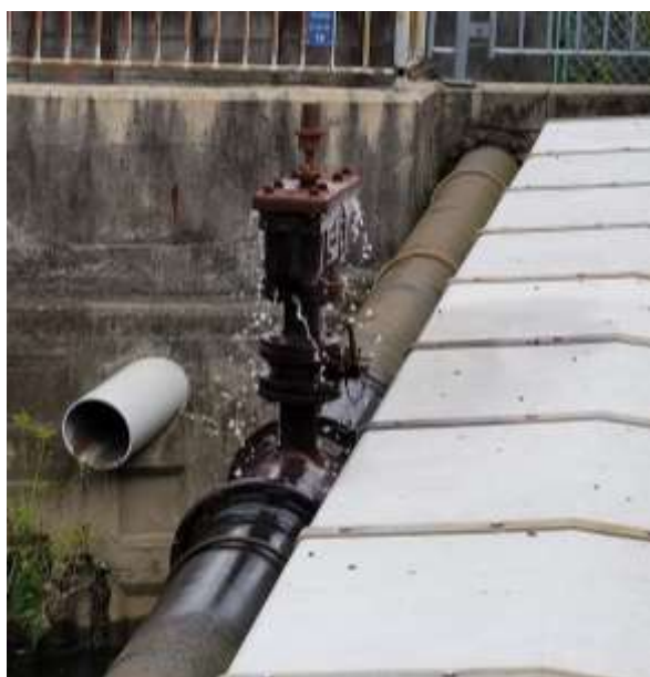
②-13：φ300DIP（空気弁から漏水）
