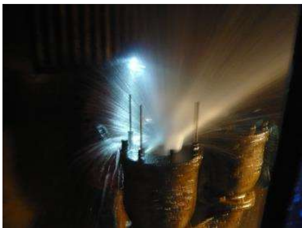
①-23 : \phi 2200DIP (空気弁から漏水)
