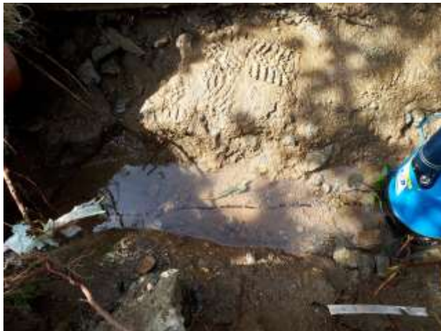
①-15 : \phi 300CIP (管体破損)
