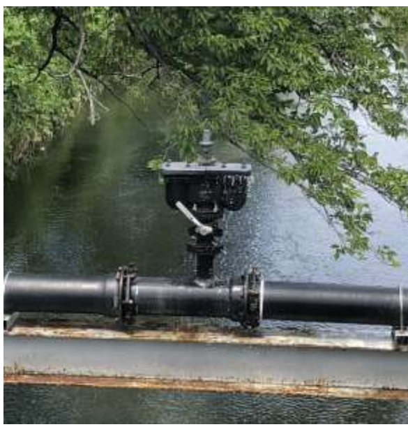
②-15：φ200DIP（空気弁から漏水）
