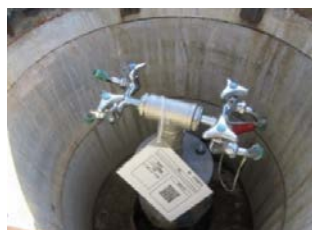
地下式給水栓への二次元コード設置状況
