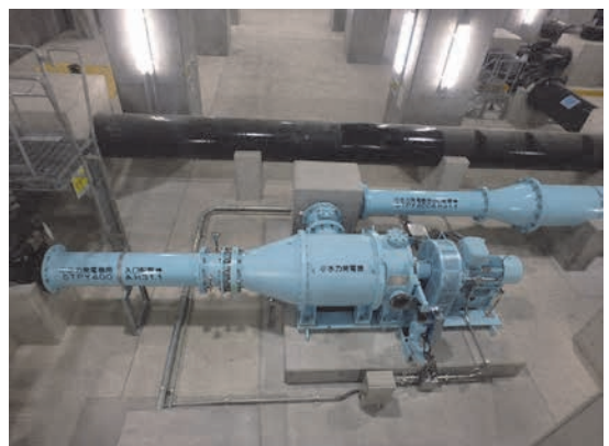
図-4 小水力発電 (江北給水所)
