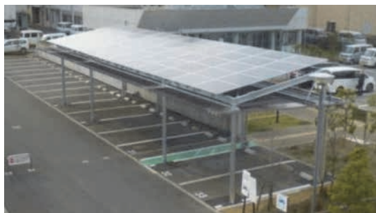
図-7 ソーラーカーポート (八王子給水事務所)
