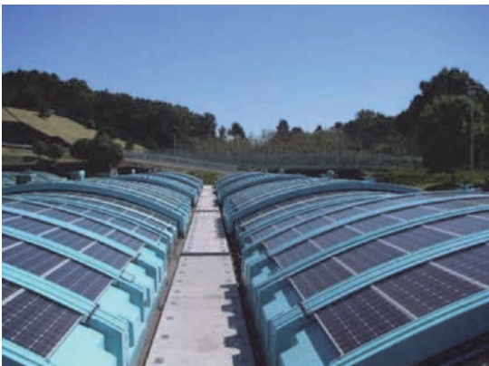
図-5 太陽光発電 (小雀浄水場)
