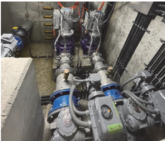
図-2 小水力発電設備 (和泉浄水池)
