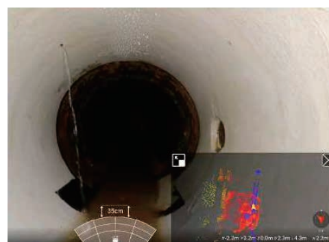
ドローン映像①(漏水箇所付近)
