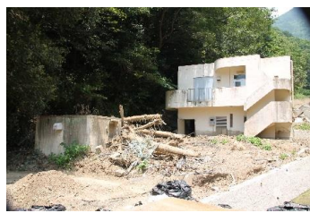
土砂が流入し、機能が停止した愛媛県南予水道企業団吉田浄水場
